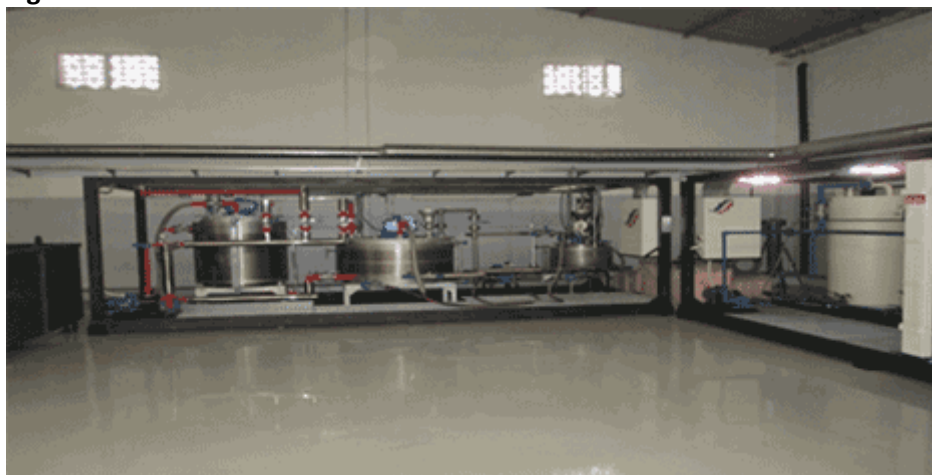
Figure 5.3 : Plateforme de traitement des PCB à Bouskoura
