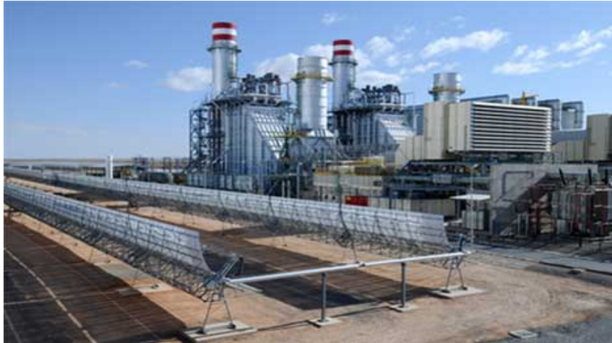
Figure 5.2 : Centrale thermo-solaire d'Ain Béni Mathar (ABM)
